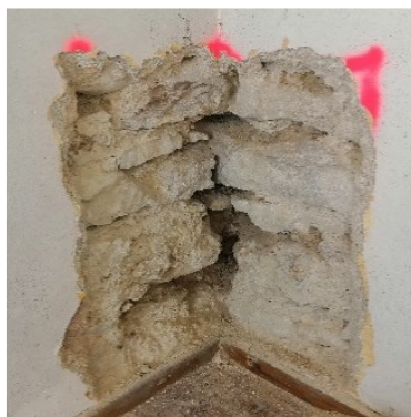
Fig. 4.1.12 Scarso ammorsamento tra pareti ortogonali.
