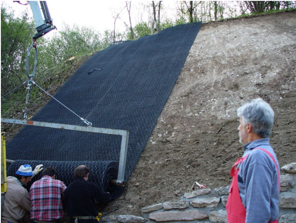
Foto n°22, pendio franoso in località Pietena, comune di Seren del Grappa.
