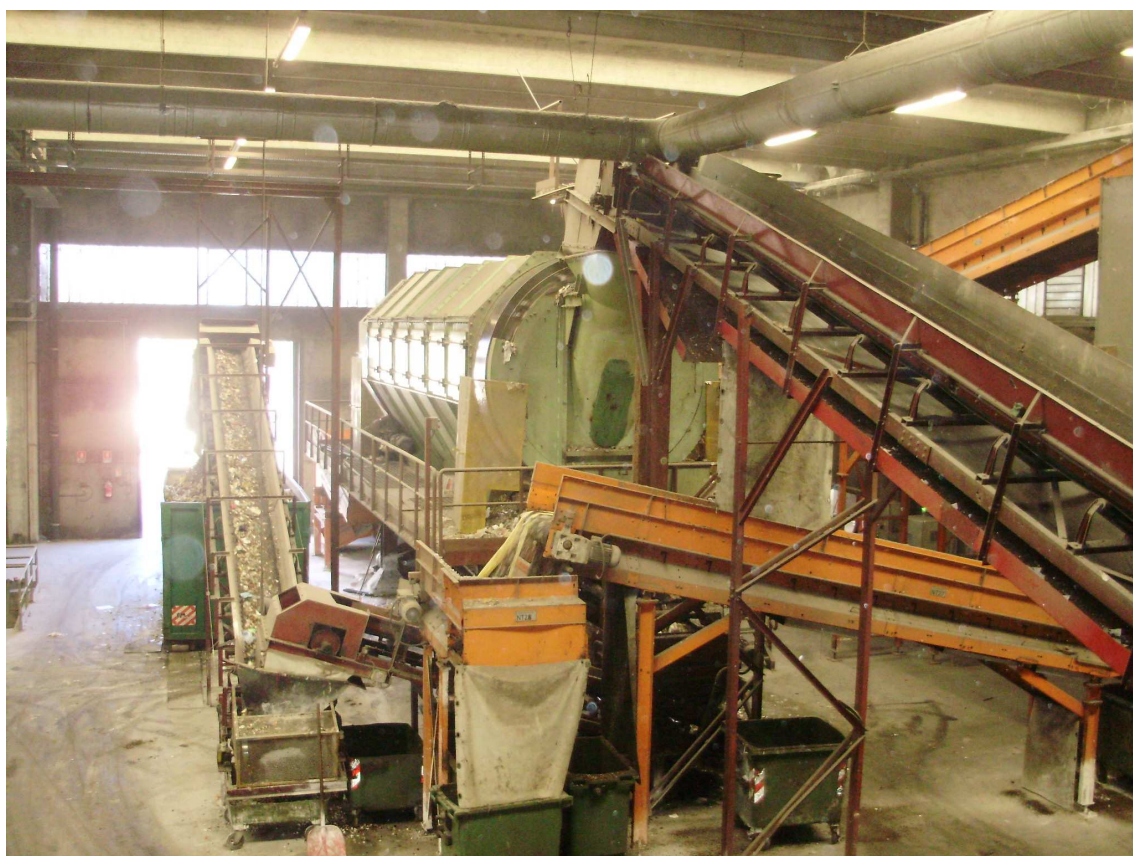
Figura 2.10: Macchinario per l'operazione di vagliatura con separazione della frazione umida (Lovadina (TV), 2010)
