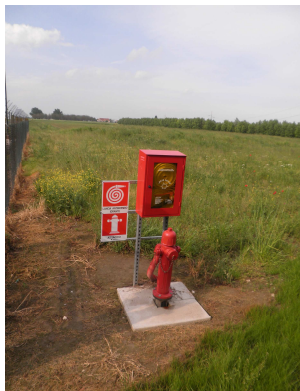
<Foto 4.2> Allacciamento idrico e manicotto antincendio presso l'impianto della TENUTA DI BAGNOLI
