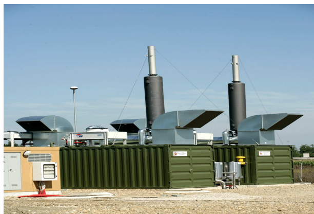
<Foto 6.6> Le due unità di cogenerazione da 500 kW fornite dalla ditta "DREYER & BOSSE"
