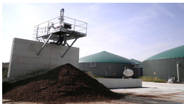
<Foto 1.18> Frazione solida del digestato in uscita dal separatore
