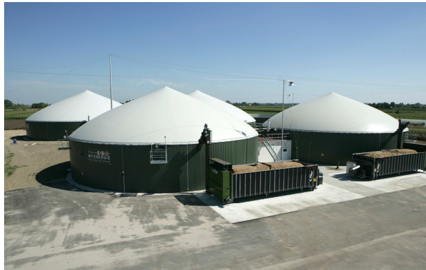
<Foto 6.5> Vista dall'alto dell'impianto da 999 kW della cooperativa CAT di Correggio
