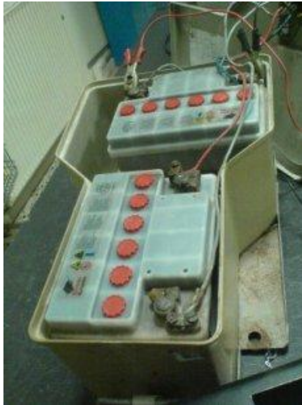
Fig. 48 accumulatori al piombo in manutenzione. Pacco batterie
