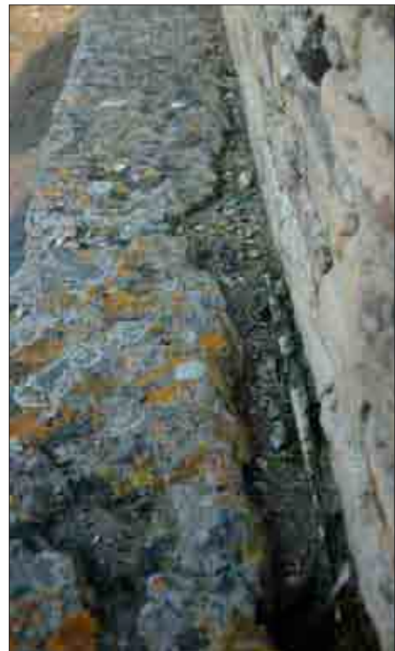
Fig. 71. Rapporto tra il cordolo della via E-G , a sinistra, ed il perimetrale nord delle Terme a mare, a destra, vista da ovest (foto S. Berto, aprile 2011).
