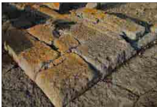
Fig. 72. Basamento presso il punto G , lungo il margine orientale della via G-H , vista da sud-ovest (foto S. Berto, aprile 2011).
