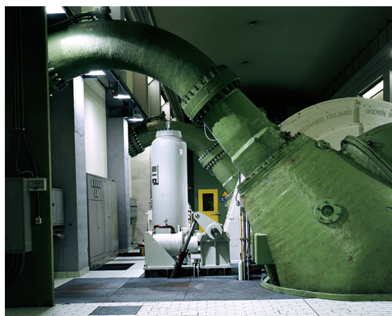
Fig. 5.4 – Sala macchine della centrale di San Floriano [foto di Enrico Minasso]
