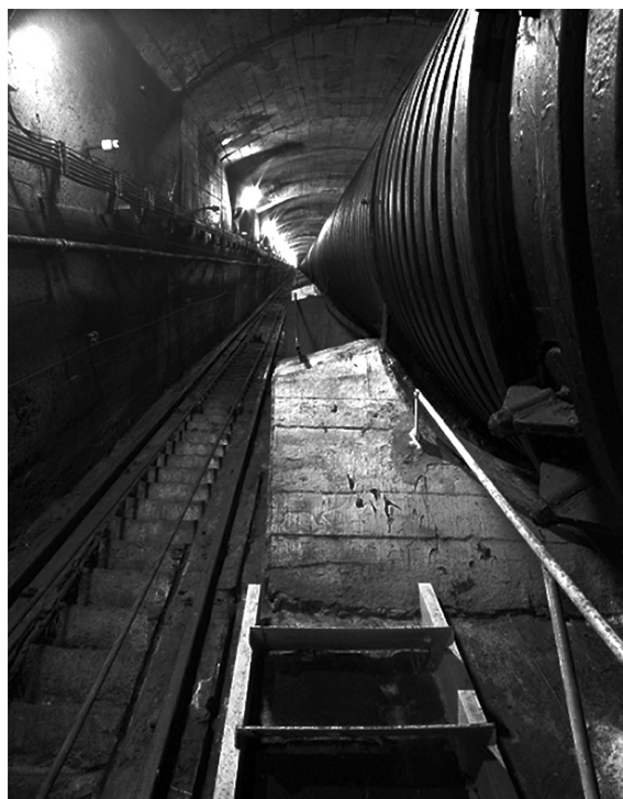
Fig. 5.3 – Condotta forzata dell'impianto di San Floriano [foto di Enrico Minasso]
