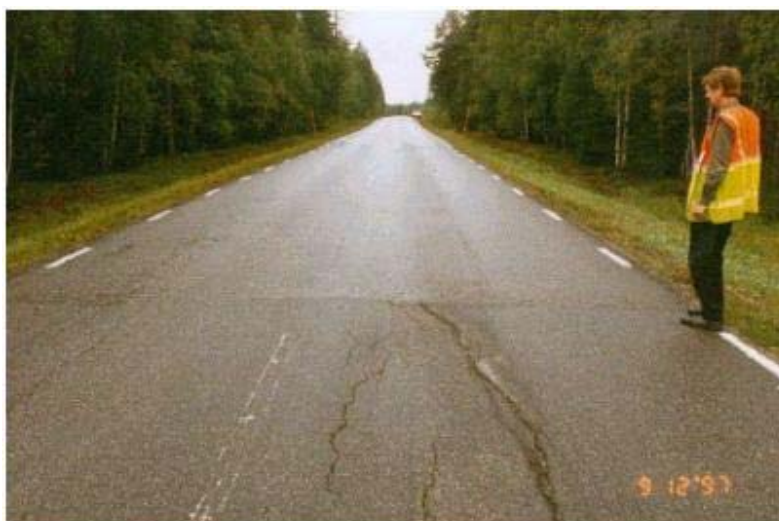
Fig. 3. Fessura longitudinale: si nota il suo termine all'inizio della zona rinforzata con rete elettrosaldata, Strada 742 Aneset-Flarken, Svezia.
