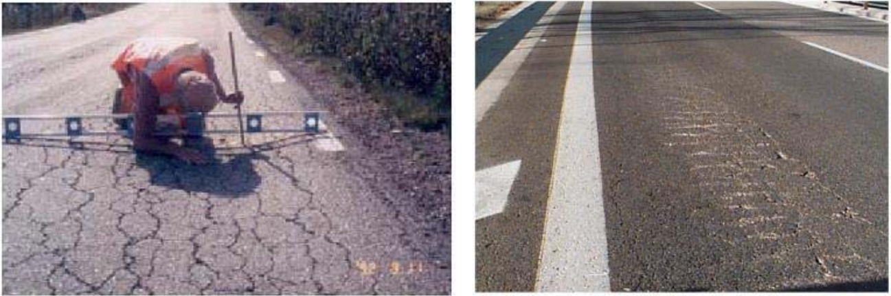
Fig. 1. Ormaiature e fessure a pelle di cocodrillo prima della manutenzione, Strada 771 Hysta-Arkhyttan, Svezia.
