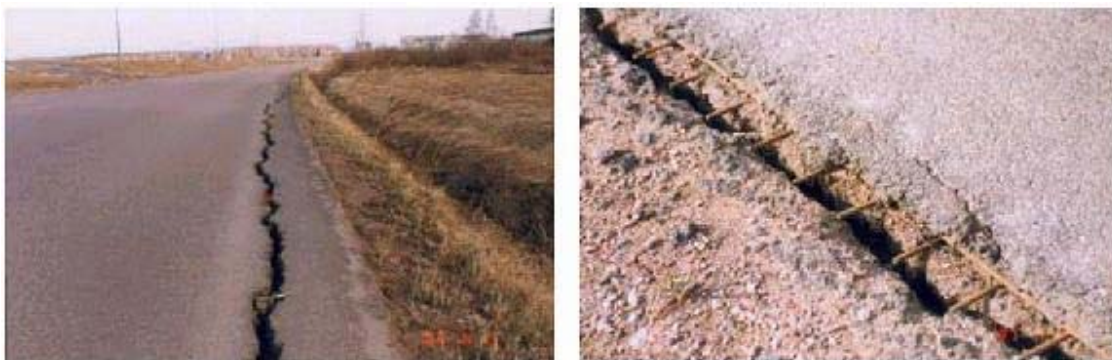
Fig. 7.40. Fessura trasferita al bordo della zona rinforzata.
