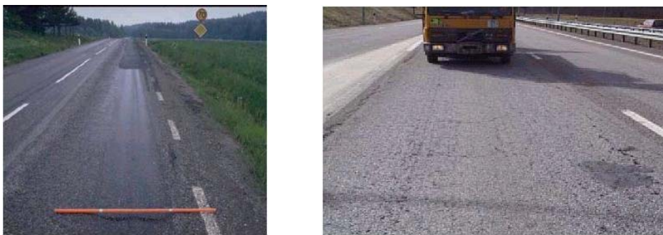
Fig. 1. Nuovi cedimenti dopo il rattoppo con semplice conglomerato bituminoso.
