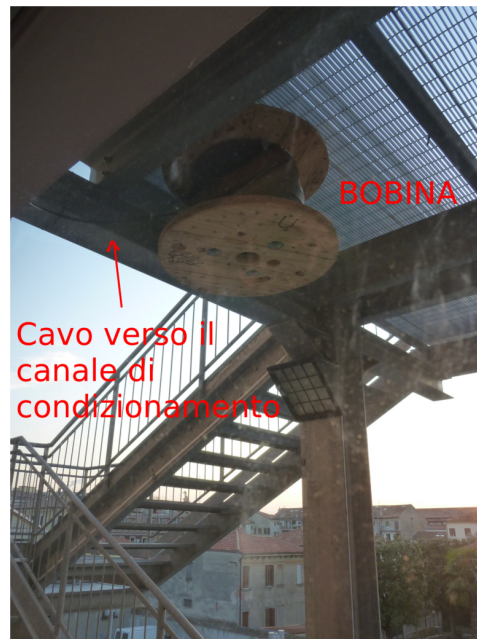
Figura 6.1: La bobina del cavo in fibra ottica in analisi opportunamente fissata
