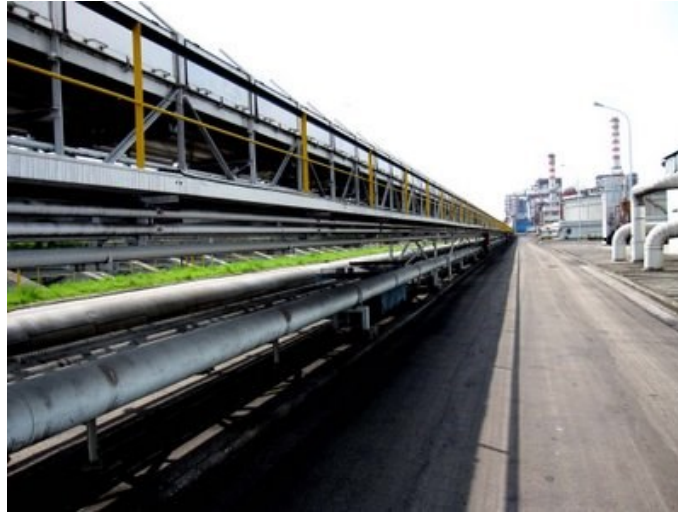
Figura 9. Tubazioni per il trasporto di idrogeno.
