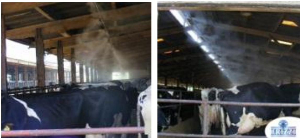
Fig. 14: Sistemi di nebulizzazione: utilizzano l'acqua nebulizzata per abbattere la temperatura. Con un sistema di pompe pressurizzano l'acqua filtrata a 60-100 bar, e attraverso degli speciali ugelli l'atomizzano in particelle di 10 micron. Grazie al processo della dinamica termica, l'acqua nebulizzata evapora istantaneamente abbassando la temperatura e senza bagnare l'animale. Vaporizzando appositi prodotti, inoltre, questi sistemi abbassano il livello degli odori e aiutano a sanificare l'ambiente.
