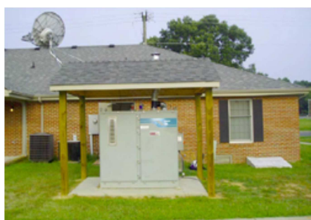
Figura 2.9 – Unità da 2 kW alimentata a propano in Virginia (IdaTech).
