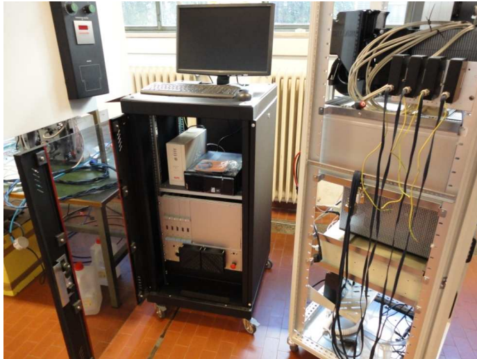
Figura 4.23 - Carico elettronico e sistema di acquisizione dati Mmates.
