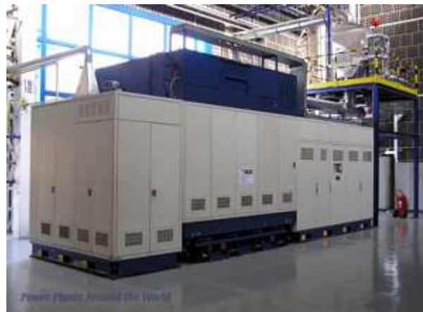
Figura 1.18a - Impianto CHP100 da 104 kW el e 65 kW t a Torino (TurboCare).
