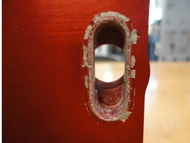
Figura 7.2 - Foro di ingresso dell'acqua di raffreddamento.
