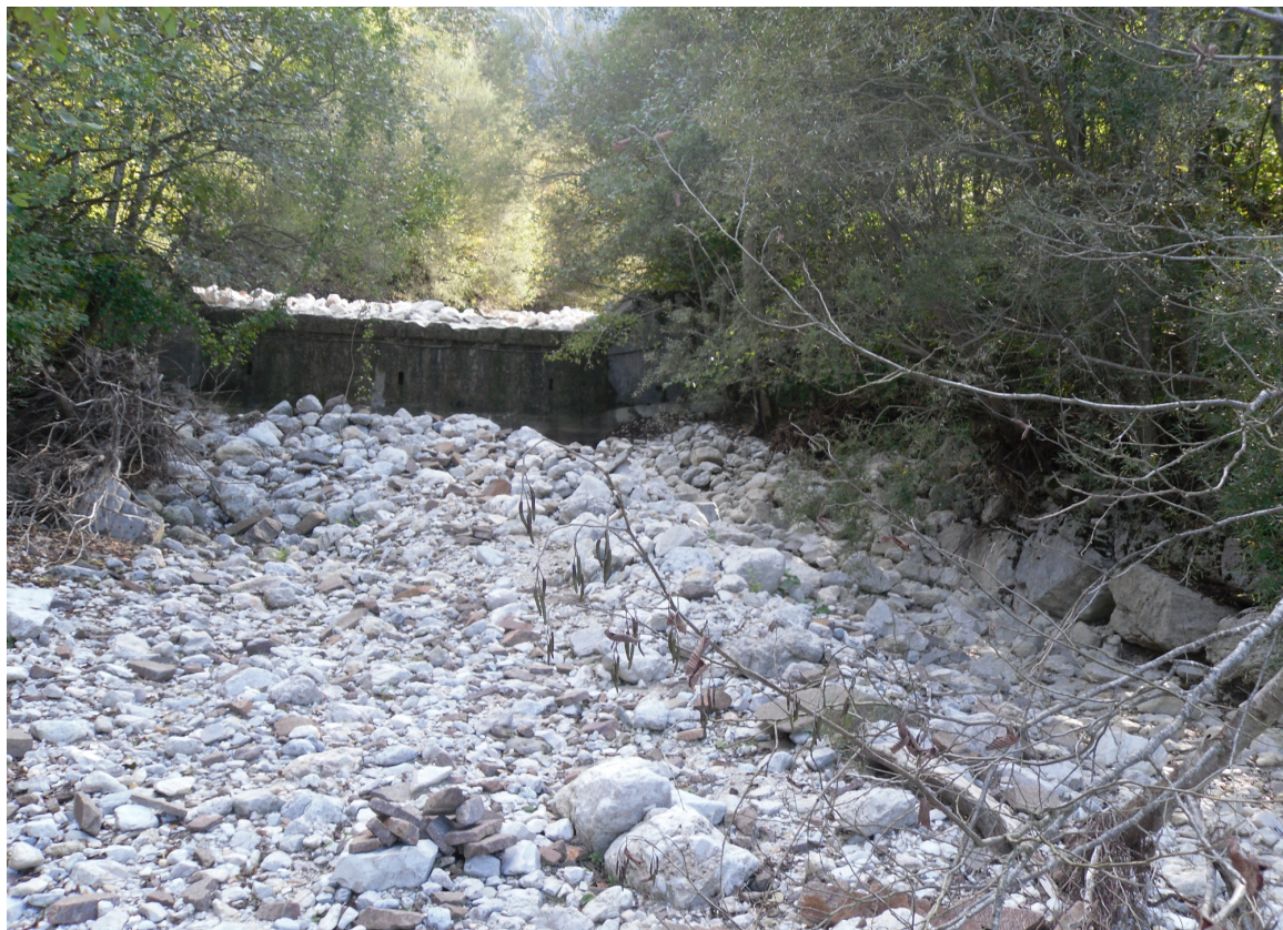
Fig. 5.19 Materiale depositato tra la briglia n° 5 e n° 6 (a monte della piazza di deposito).
