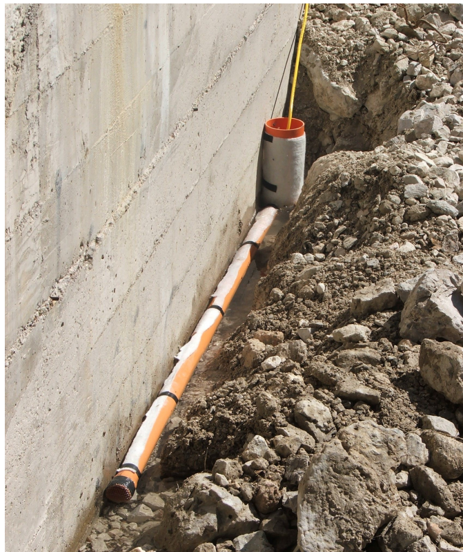
Fig. 7.4 Tubo forato di captazione dell'acqua di collegamento tra il pozzetto del piezometro e il piano della gaveta della briglia (fonte: Gregoretti C.,2011).
