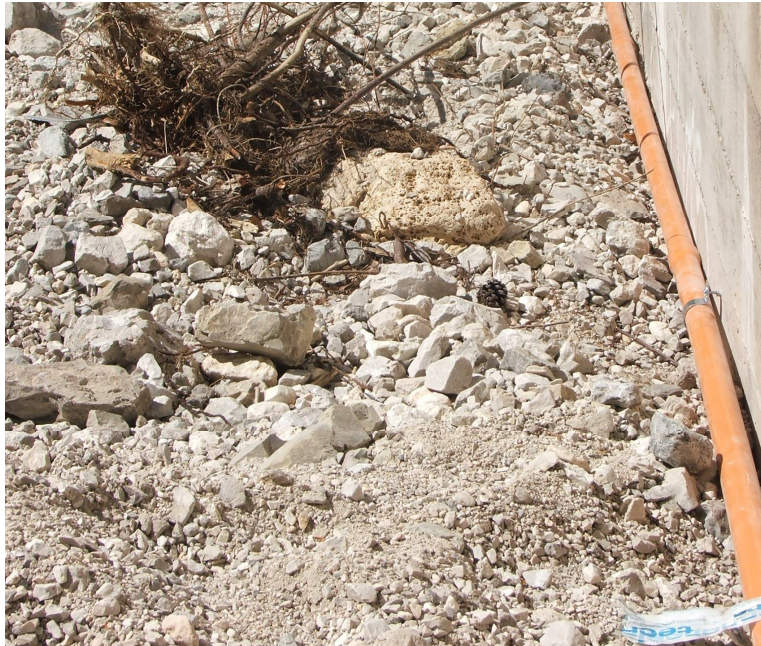
Fig. 7.5 Tubo protettivo in pvc contenente il cavo del piezometro (fonte: Gregoretti C.,2011).
