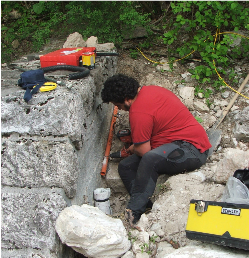
Fig. 7.10 Ancoraggio del tubo in pvc, contenente il cavo del sensore, all'ala della briglia e pozzetto per il piezometro (fonte: Gregoretti C., 2011).
