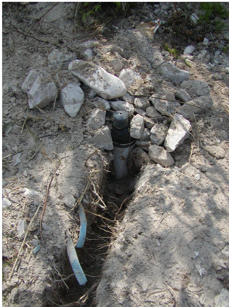
Fig. 7.6 Pozzetto contenente il piezometro (fonte: Degetto M.,2011).
