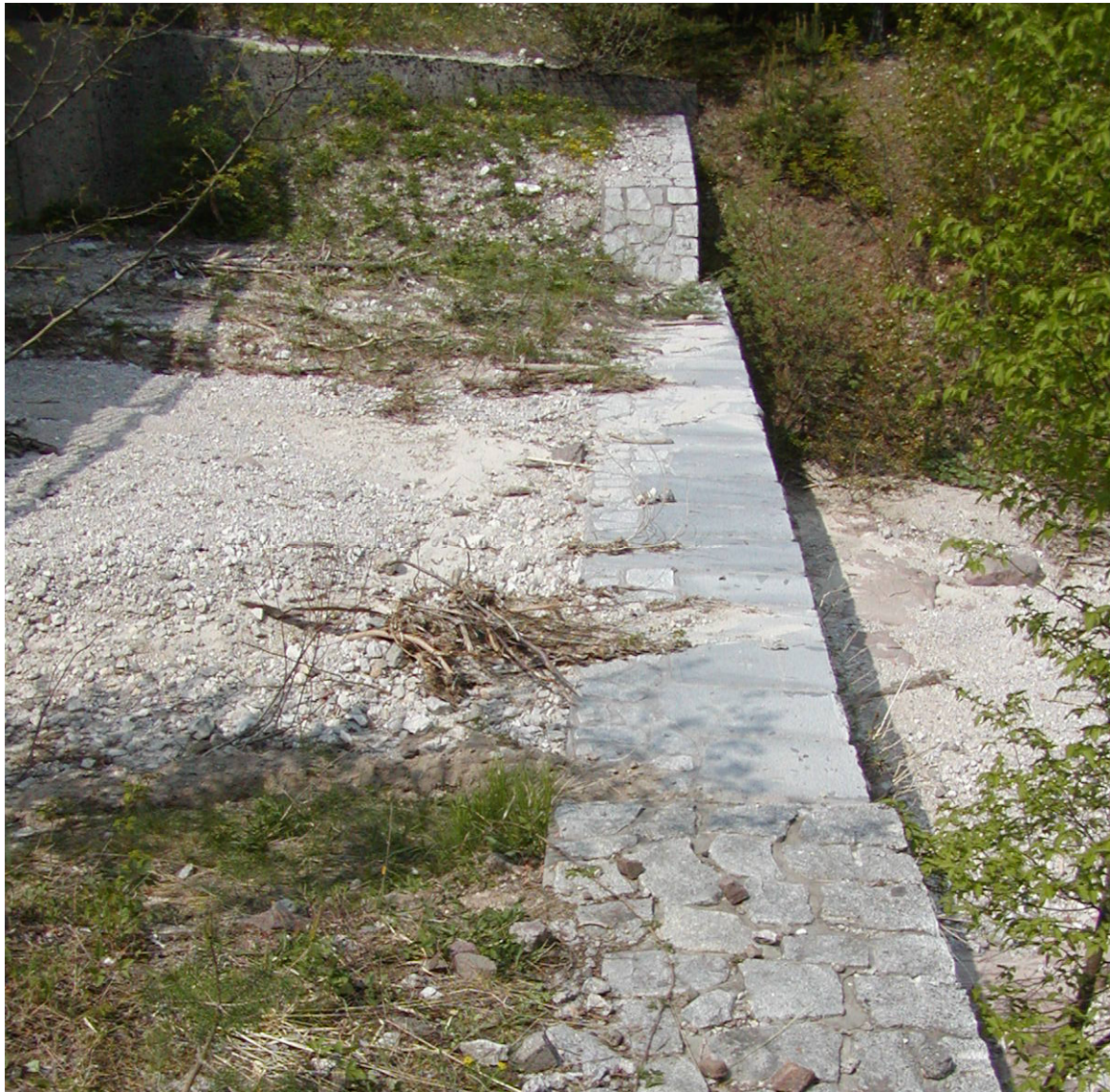
Fig. 7.19 Gaveta della briglia n°1 del rio Rì posta a valle della filtrante e del ponte della strada provinciale. Il pozzetto con il piezometro è esterno alla foto (in sinistra) mentre il tubo drenante di captazione che giunge fino alla gaveta termina sotto l'accumulo di ramaglia visibile in foto.
