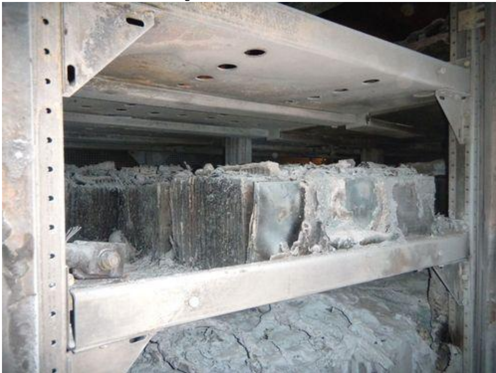
Fig. 23: alcune UPS bruciate
