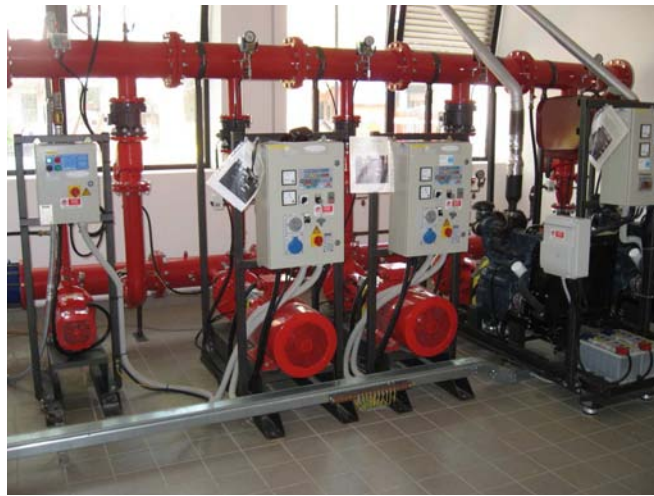
(a) Pompe installate nella stazione Ghetto - Comparetti.
