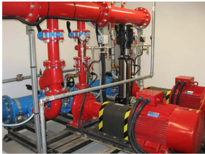
(a) Pompe installate nella stazione Gesuiti.
