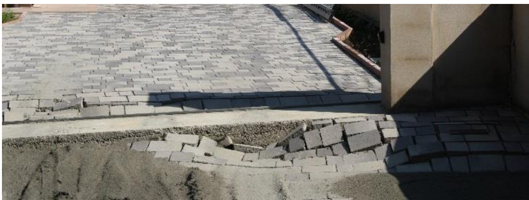
Figura 2.15: Abbassamento del suolo conseguente alla liquefazione a San Carlo (FE)
