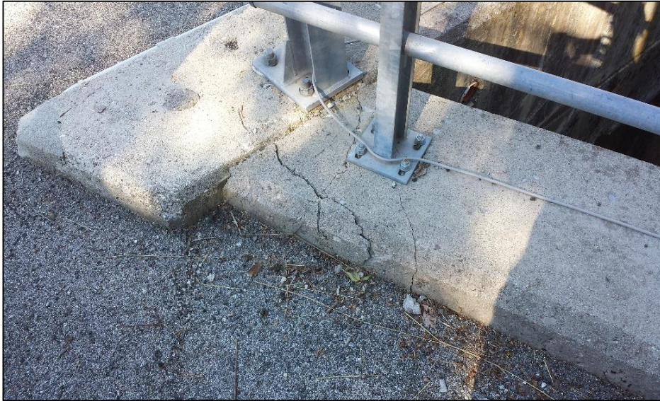
Figura 7.0.2. Fessure presso il ponte sul Rio Verde
