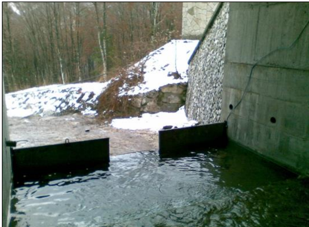
Figura 4.1.6. Idrometro per la misura della portata del Rio Verde
