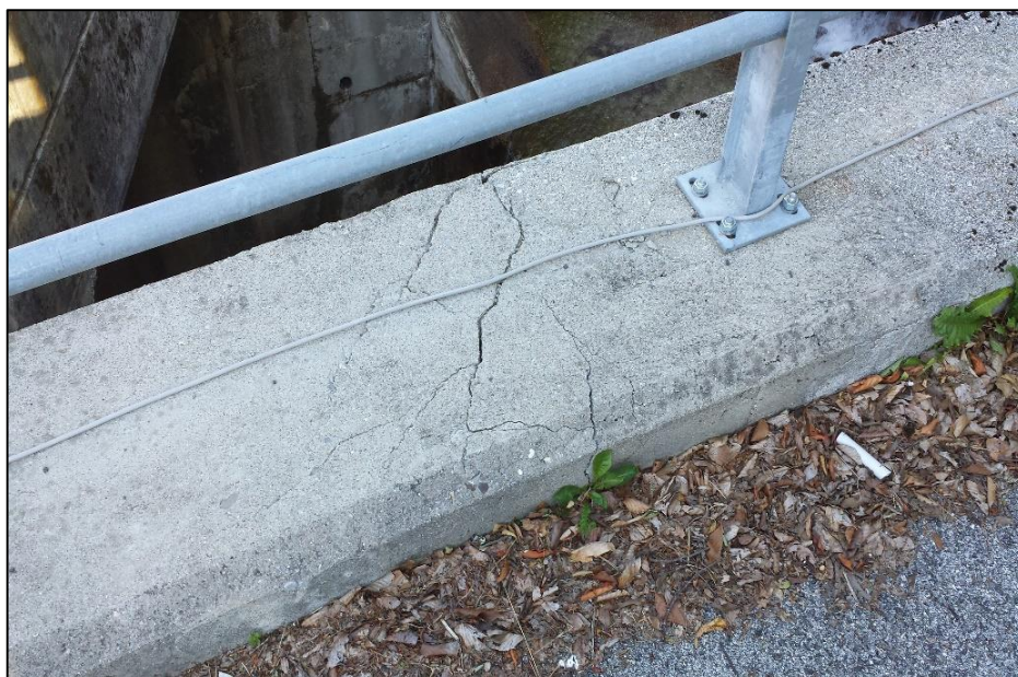
Figura 7.0.1. Fessure presso il ponte sul Rio Verde
