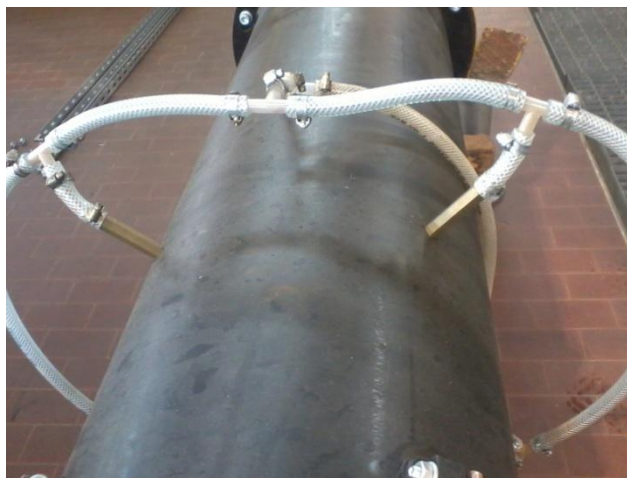
Fig. 5.5 – sistema di collegamento tra tubatura e trasduttori
