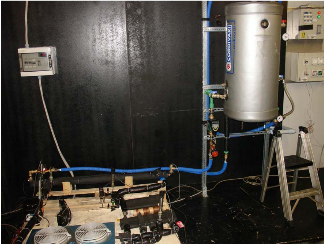
Figura 27 Prototipo sperimentale dell'Impianto a pompa di calore per la produzione di ACS
