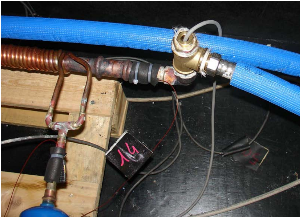
Figura 20 Sonda di temperatura, inserita in ingresso al condensatore lato acqua, collegata al termostato
