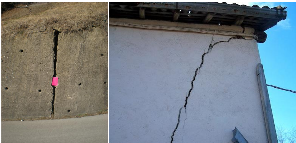
Figura 7. Particolare delle lesioni subite da muri di contenimento ed edifici a causa di deformazioni dei terreni di fondazione.
