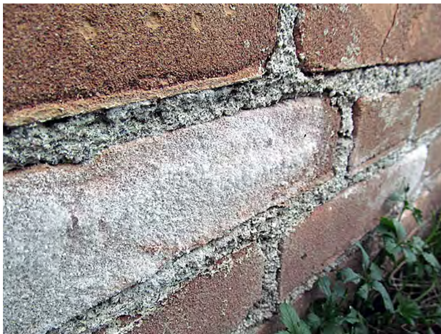
Figura 1.11: Efflorescenza aghiforme su mattone in laterizio
