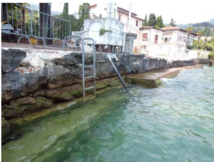
Fig. 7.1 – Panoramica sia del dissesto del muro che dello zoccolo
