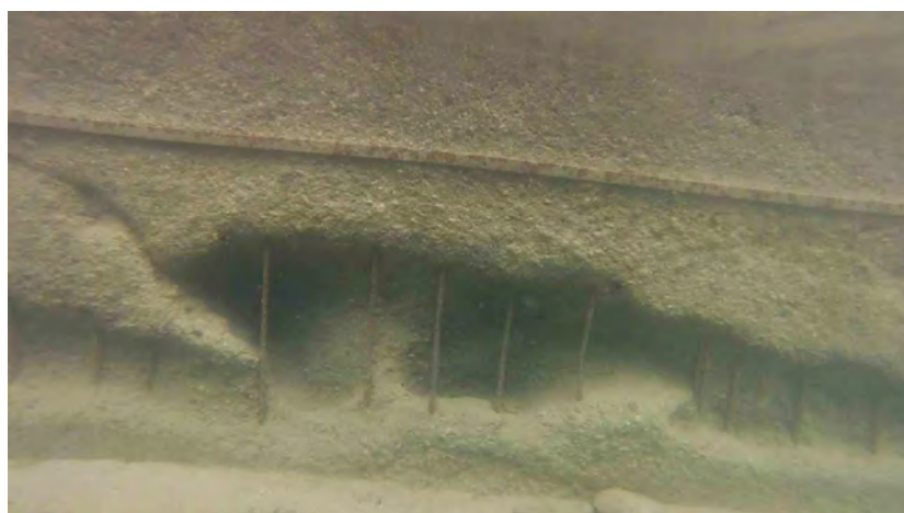
Fig. 7.2 – Particolare dei ferri d'armatura ormai totalmente scoperti
