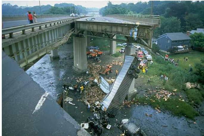
Figura 2.9: La campata crollata sul fiume Mianus
