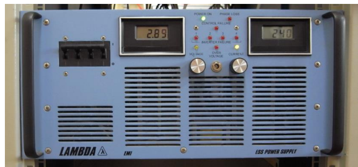
Figura 4.11: trasformato usato nel laboratorio per l'erogazione della corrente riscaldante. Sul pannello frontale si possono leggere corrente che circola (chiamata finora I_{LINE} , sulla destra) e differenza di potenziale applicata (che sarà nominata V_{MS} , sulla sinistra), che sono regolabili manualmente agendo sulle manopole sottostanti.
