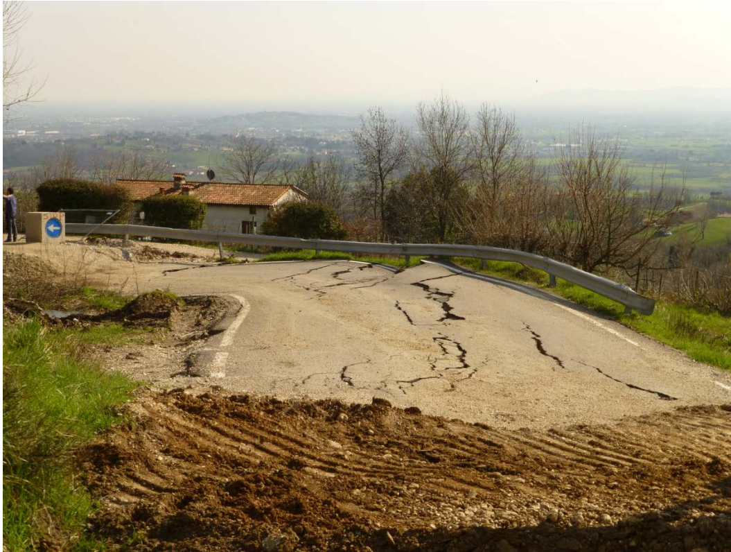
Fig.12: Sede stradale dissestata (Foto: 5 marzo 2014)
