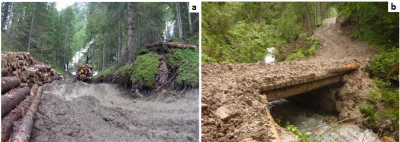
Figura 1.2 Effetto dell'utilizzo di forwarder di grandi dimensioni e a pieno carico al transito su pista forestale permanente(a) e su viabilità forestale principale(b) in condizioni non ottimali(Val del Boite, BL)
