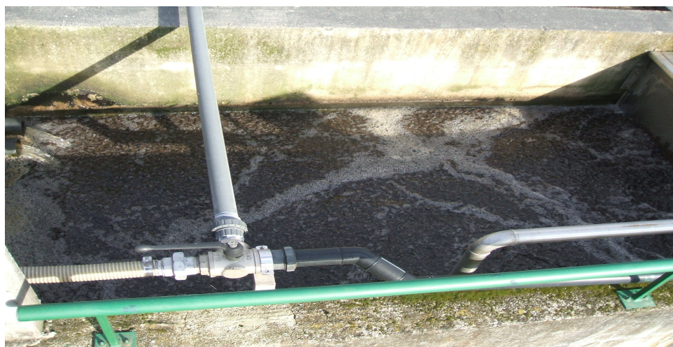
Fig. 3.6: Reattore MBBR di nitrificazione terziaria.
