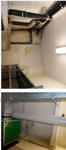
L.1 Alterazione cromatica, distacco, macchia. L.1 Espulsione del copriero, fessurazione
