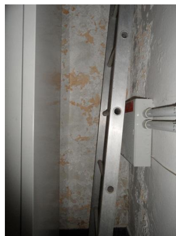
Fig. 6.4.2-15: PT, soppalco: alterazione cromatica, distacco, rigonfiamento.
