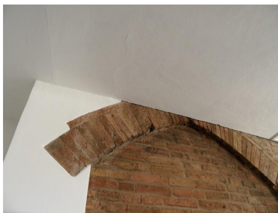
Fig. 6.4.3-02: Zona di raccordo fra la parete di connessione e la copertura: si nota il distacco fra le due parti.
