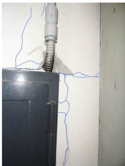
Fig. 6.4.1-07: Interrato: lesioni dovute a passaggi impiantistici.
