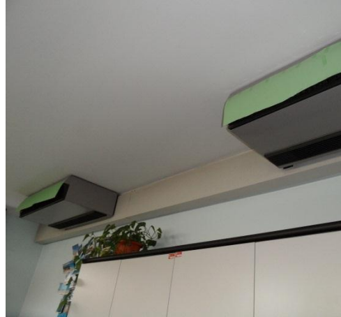
Fig. 7-06: 3P: ventilconvettori a soffitto.
