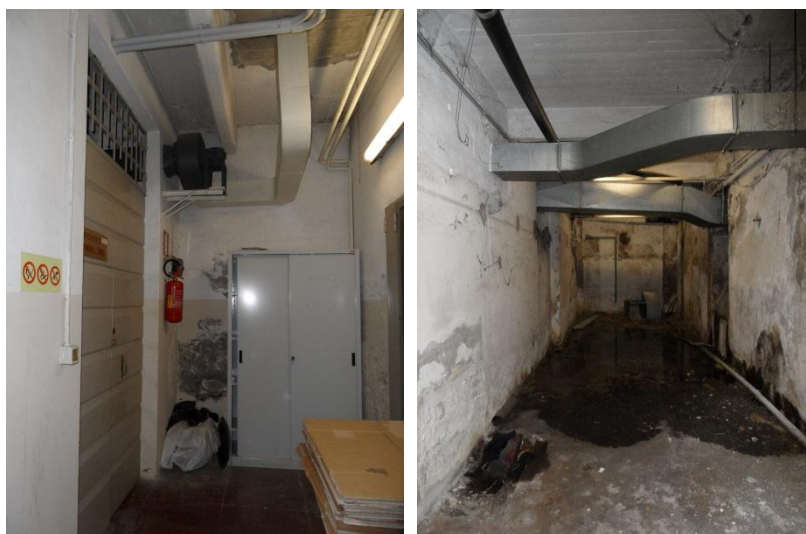
Fig. 7-01, 02: Interrato: impianti a vista al di sotto del soffitto.
