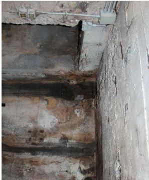
F.6 Alterazione cromatica, distacco, colatura
