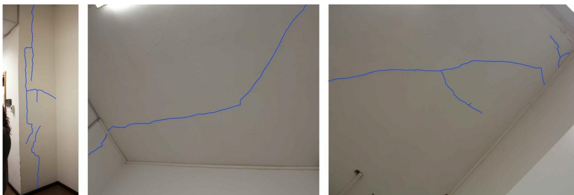
Fig. 6.4.1-18, 19, 20: 3P: lesioni nella zona di raccordo fra Palazzo Moretti-Scarpari e Palazzo degli Anziani. La lesione parte dalla parete (fig. 6.4.1-18) e si estende sul soffitto (fig. 6.4.1-19, 20).
