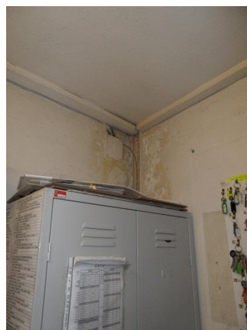
Fig. 6.4.2-14: PT, zona sud: alterazione cromatica, distacco.
