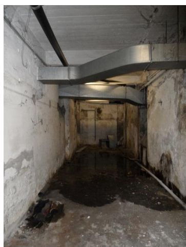
Fig. 6.4.2-07: Interrato, zona sud-ovest: presenza di liquami, fronte di risalita.
