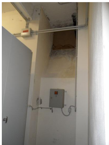
Fig. 6.4.2-11: Interrato, zona nord: distacco, colatura.
