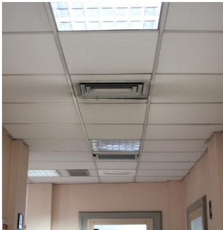
Fig. 7-07: 3P: controsoffitto e bocchette d'aerazione.
