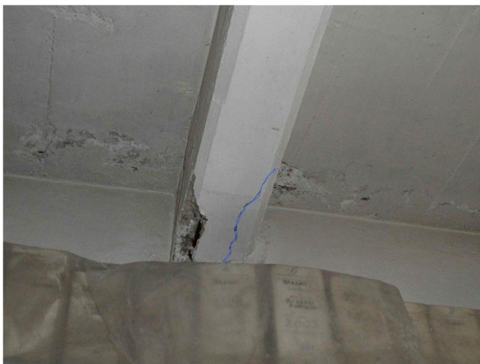
Fig. 6.4.1-01: Interrato: lesione sulla trave per espulsione del copriferro.
