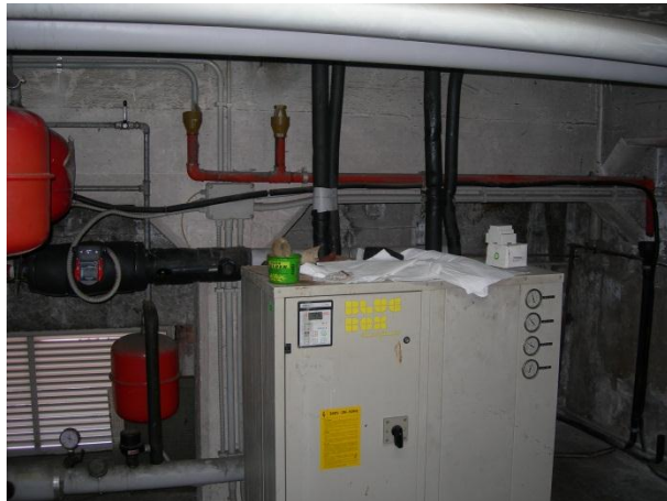
Fig. 7-08: Torre campanaria: centrale di condizionamento.
