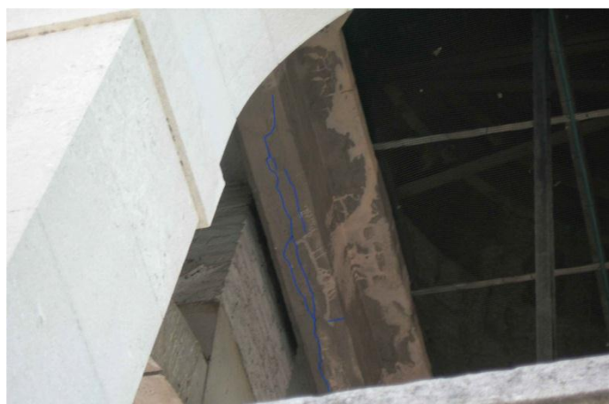
Fig. 6.4.1-21: Torre campanaria: lesioni sulla trave a T.
