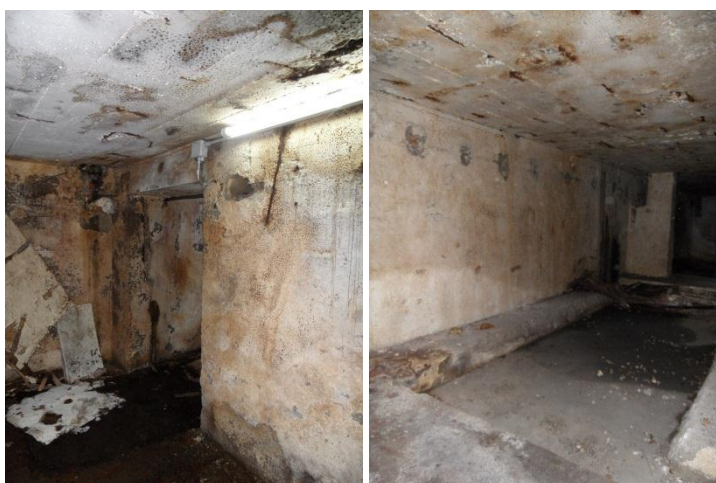
Fig. 6.4.2-08,09: Interrato, ex rifugio antiaereo: presenza di liquami, espulsione dei copriferri, alterazione cromatica, distacco, fonte di risalita.
