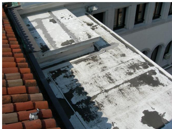
Fig. 6.4.2-21: Copertura terrazze: degrado del manto impermeabile.
