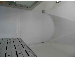
D.1 Alterazione cromatica, distacco, rigonfiamento
