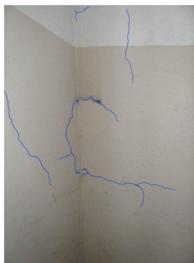
Fig. 6.4.1-04: Interrato: lesione diffusa fra pareti ortogonali.
