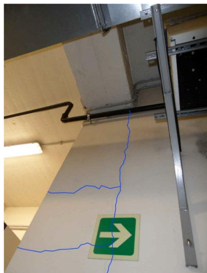
Fig. 6.4.1-05: Interrato: lesione verticale che si propaga dalla trave.
