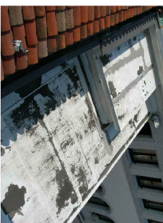
A.1 Degrado del manto impermeabile
