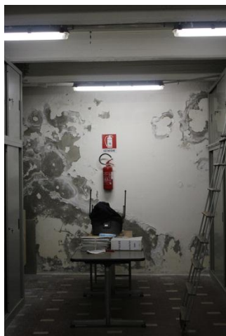
Fig. 6.4.2-10: Interrato, zona sud-ovest: distacco, fronte di risalita.
