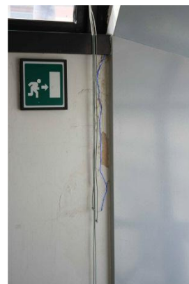
Fig. 6.4.1-17: 3P: lesione fra la passerella e la muratura.
