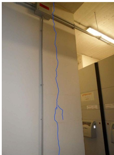
Fig. 6.4.1-06: Interrato: lesione verticale che si propaga dalla trave.
