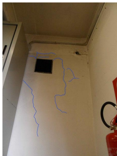
Fig. 6.4.1-08: Interrato: lesioni dovute all'apertura del condotto d'aerazione.
