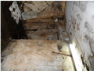
F.3 Alterazione cromatica, espulsione del copriero, fronte di risalita
