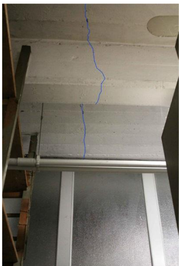
Fig. 6.4.1-01: Interrato: lesione su travi e solaio.
