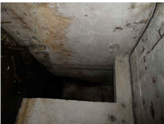
F.2 Alterazione cromatica, espulsione del copriero, fronte di risalita
