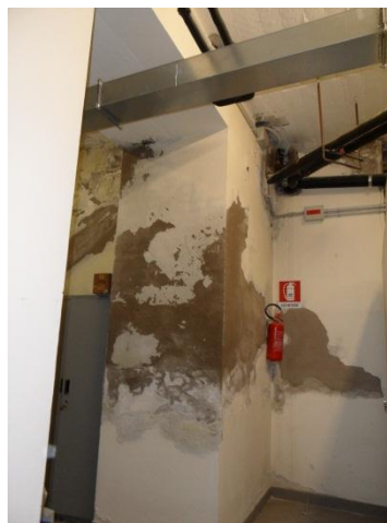
Fig. 6.4.2-12: Interrato, zona nord: distacco, fronte di risalita.
