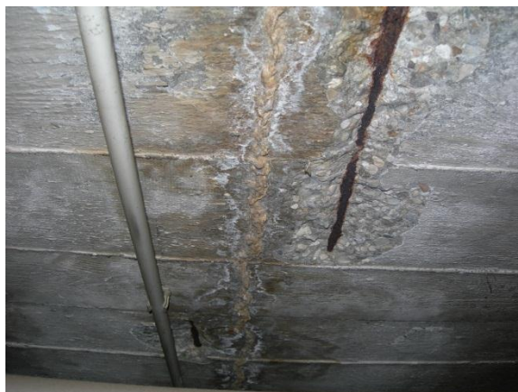
Fig. 6.4.2-22: Solaio torre campanaria: espulsione del copriferro.
