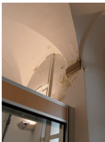
Fig. 6.4.2-13: PT, ufficio ala est: alterazione cromatica, distacco, rigonfiamento.
