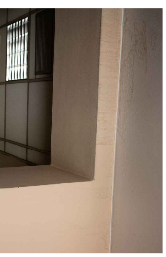
E. 1 Macchia dovuta ad umidità
