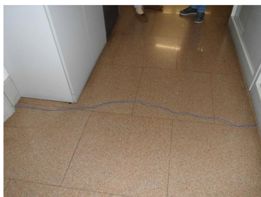
Fig. 6.4.1-13: 1P: lesione sul pavimento.
