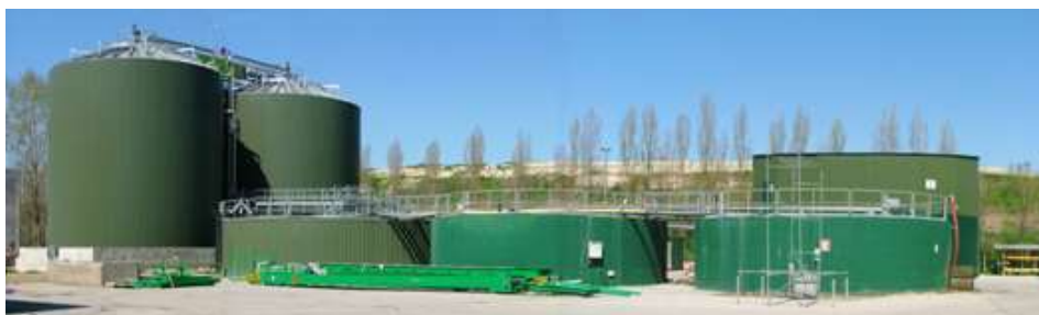
Fig. 5.2: Impianto di digestione anaerobica
