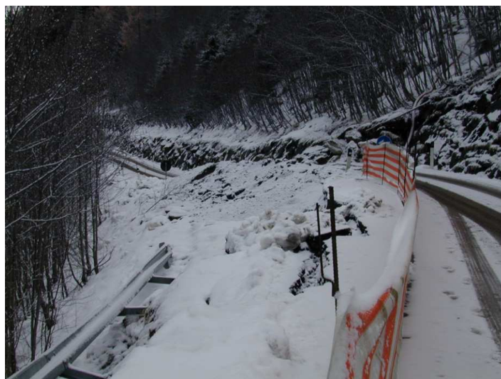
Figura 18 Collasso della sede stradale della SS44bis, avvenuto in seguito alla riattivazione del fenomeno, 20 novembre 2000
