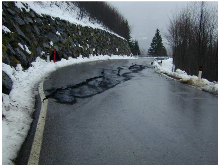
Figura 17 Danni occorsi alla sede stradale in corrispondenza dell'evento di riattivazione, 14 novembre 2000
