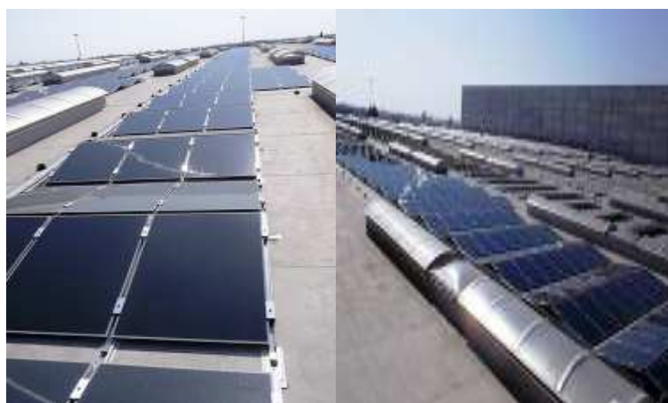
Figura 6.3.2 – Impianto fotovoltaico magazzino Ikea presso Piacenza
