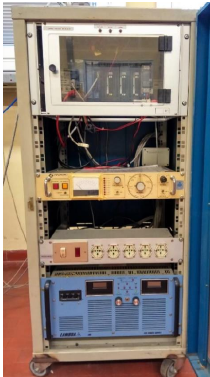
Figura 4.7: Rack contenente l'alimentatore e il PLC.
