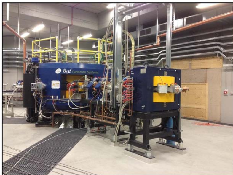
Figura 1.8.7: Ciclotrone BEST 70p prodotto dalla Best Cyclotron Systems, Inc. installato nella infrastruttura SPES presso i Laboratori Nazionali di Legnaro.
