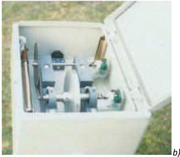
Figura 2.6 – a) Sistema estensimetrico a base multipla e b) centralina di misura per la frana del Tessina
