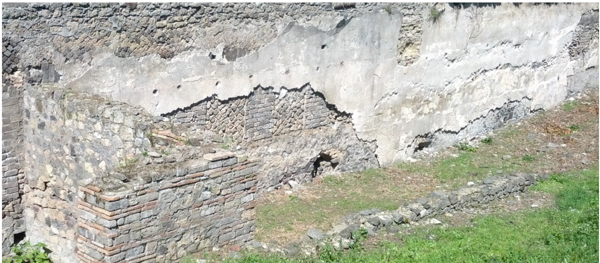
Figura 2.7 - Vista dell'esterno del muro sud del quadriportico, sono evidenti due delle numerose tamponature presenti
