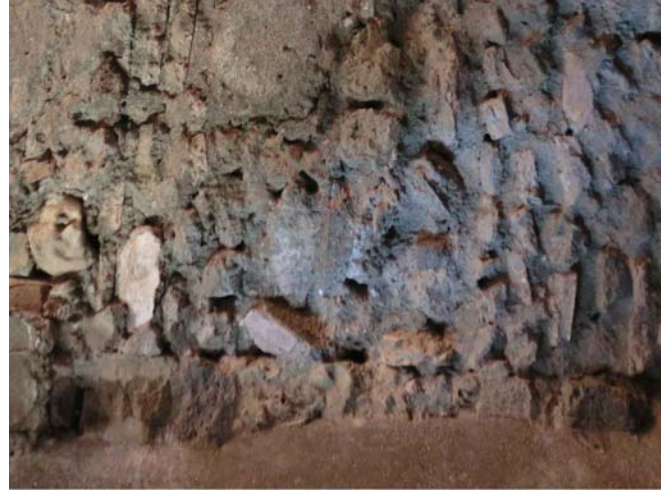
34 Assenza di ammorsamento
