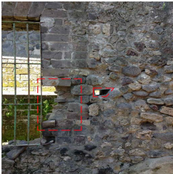
Figura 2.23 - esempio di elemento mancante
