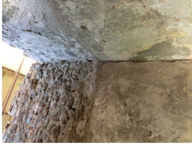
29 Assenza di ammassamento, distacco delle pareti
