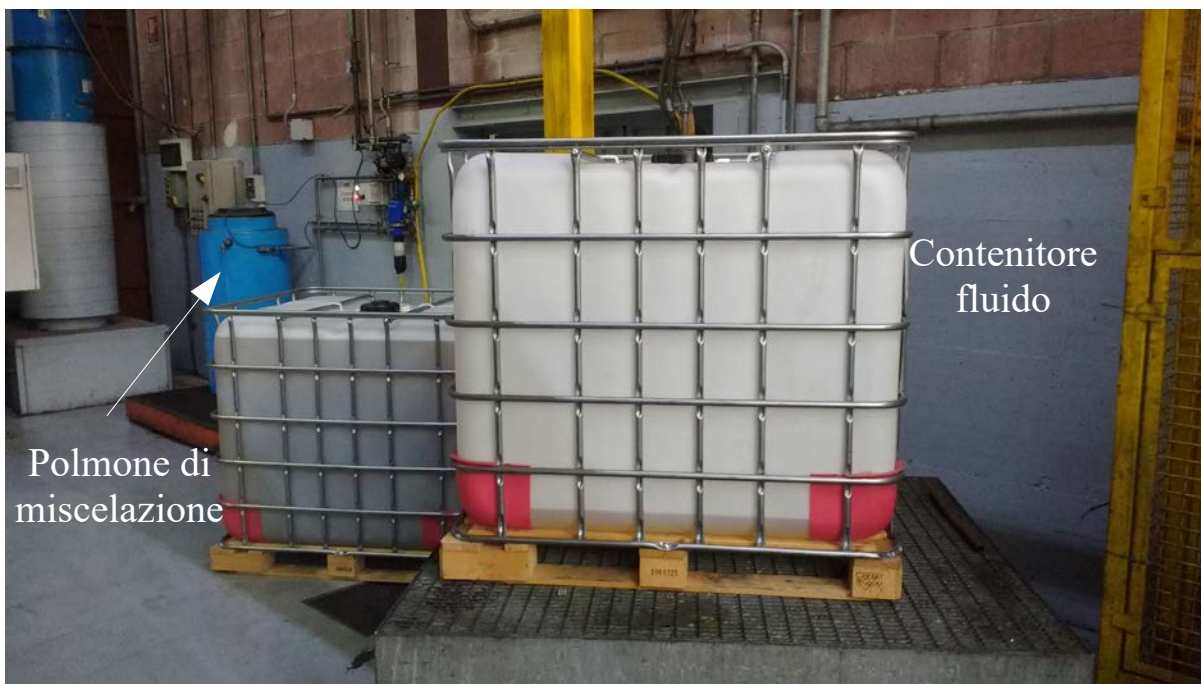
Figura 8.6: Stazione di preparazione del fluido lubrorefrigerante
