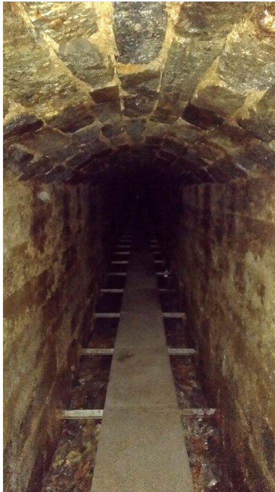
Figura 5.2 – Galleria filtrante della sorgente Gruberwiesen.
