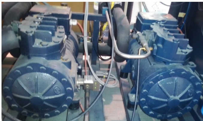
Figura 3.18: Compressori presenti nella macchina di prova
