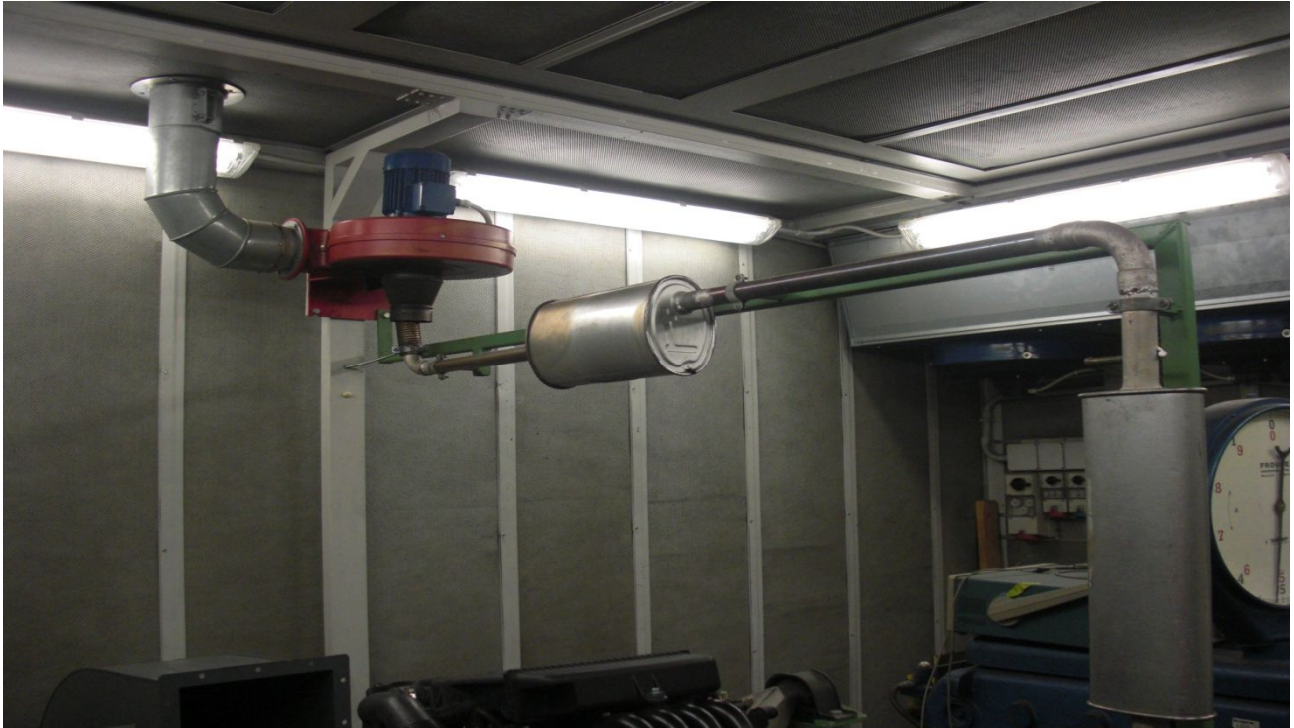
Fig. 2.2 Ventilatore centrifugo per l'espulsione dei gas di scarico.
