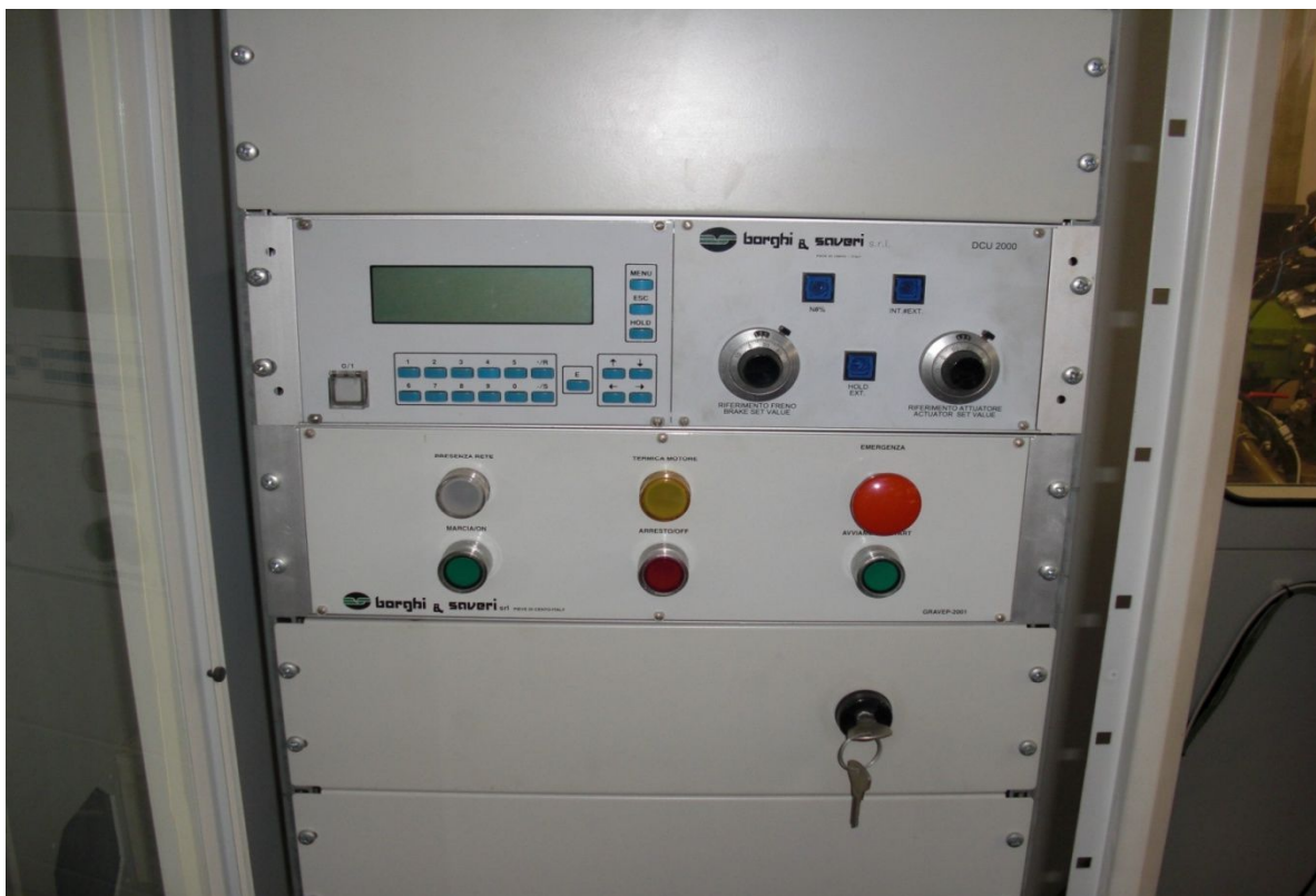
Fig. 2.7 Pannello comandi del modulo di controllo digitale Borghi & Saveri DCU 2000.
