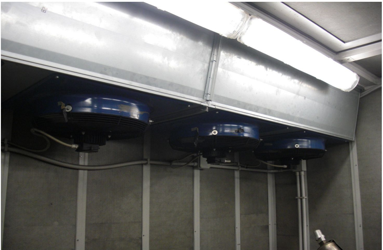
Fig. 2.3 Ventilatori assiali per il ricambio dell'aria all'interno della sala prova.
