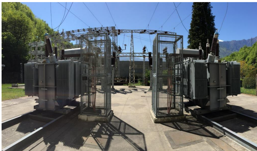
Figura 1-14 Trasformatori presenti all'esterno della centrale di Pontetto
