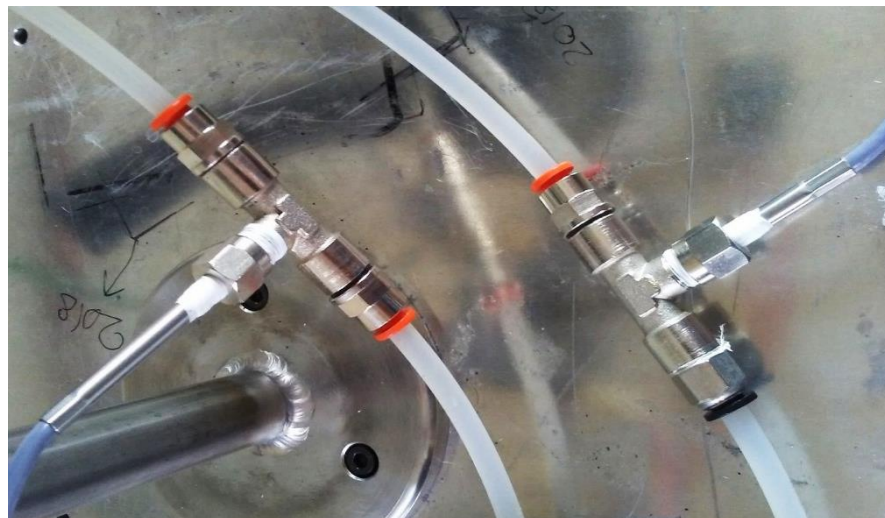
Figura 3.13: Termoresistenze RS P55/50/PT100, utilizzate per la misura della temperatura del fluido refrigerante.
