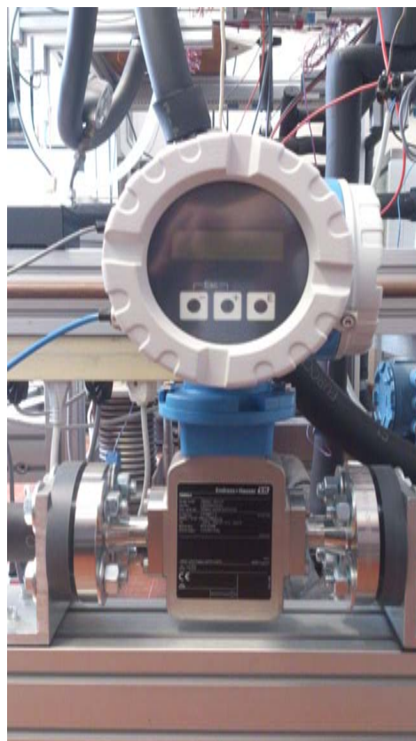
Figura 2.11: Il misuratore di portata elettromagnetico installato nel circuito dell'acqua della sezione sperimentale
