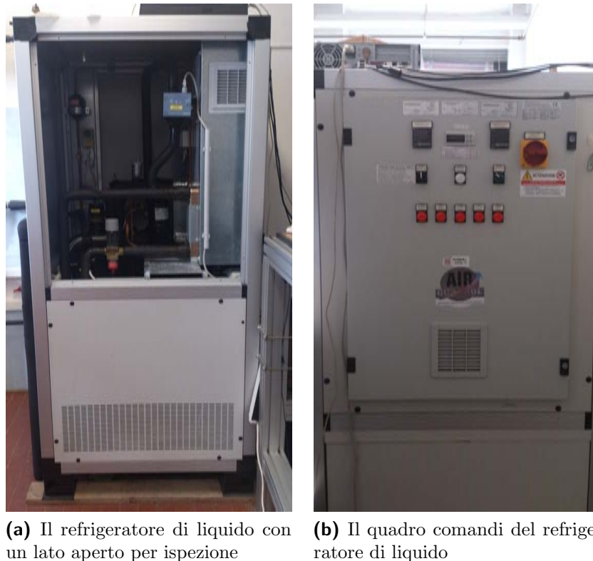
Figura 2.7: Refrigeratore di liquido che fornisce acqua al circuito del pre-condensatore
