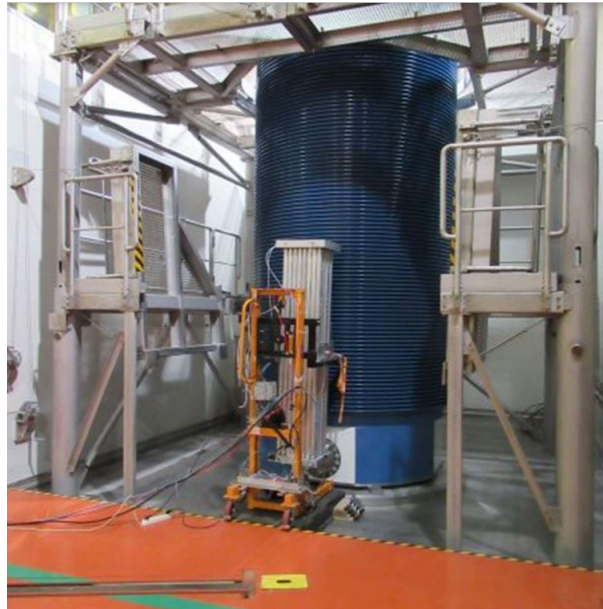
Figura 2.6: Camera 64 in prossimità di un CASTOR ® , a Neckarwestheim (Immagine: [19])
