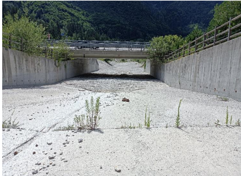
Figura 7. Cunettone in calcestruzzo (Cucco_2) in cui è possibile apprezzare il rigurgito a monte ed il deposito di materiale (ghiaia) in corrispondenza del ponte. La struttura è in buono stato, tuttavia la funzionalità è compromessa.
