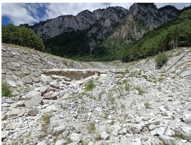
Figura 6. Soglia danneggiata "Cucco_11" in cui è evidente il cedimento strutturale della canalizzazione su cui è costruita la stessa.
