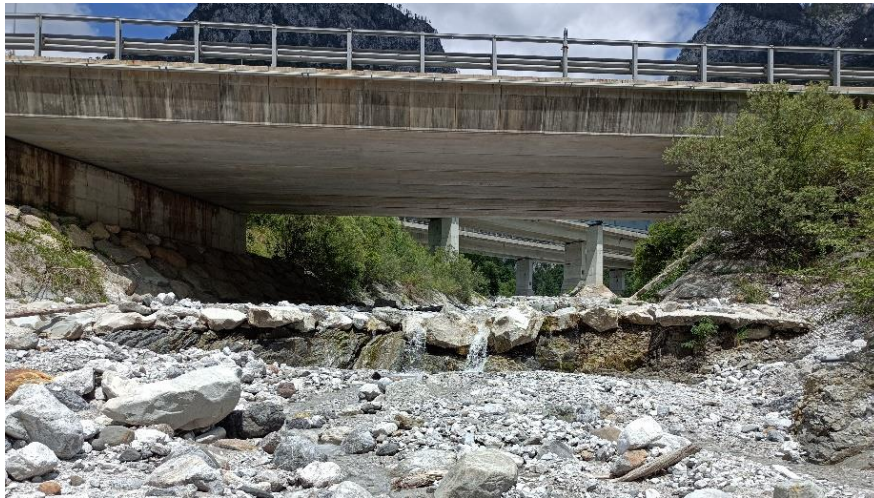
Figura 10. Briglia in massi (Uccelli_1) danneggiata dall'azione erosiva della corrente.
