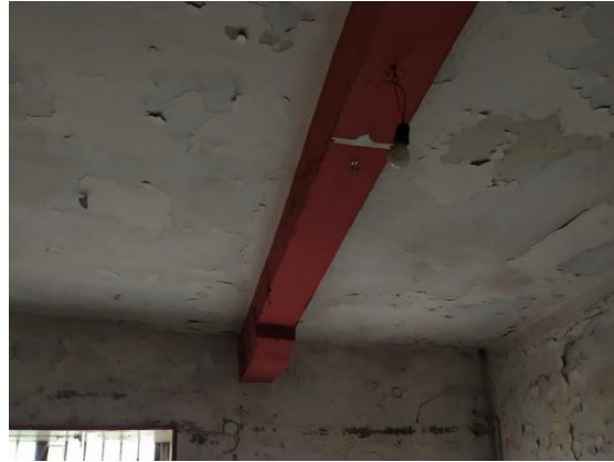
Foto 2.1.10: Trave rompitratta al piano terra del blocco E – Stato attuale
