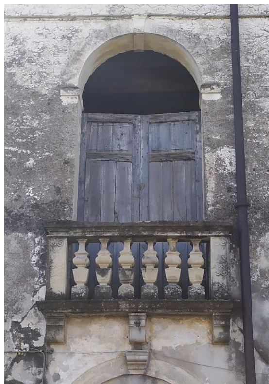
Foto 2.2.12: Balcone facciata Nord del blocco E Stato attuale
