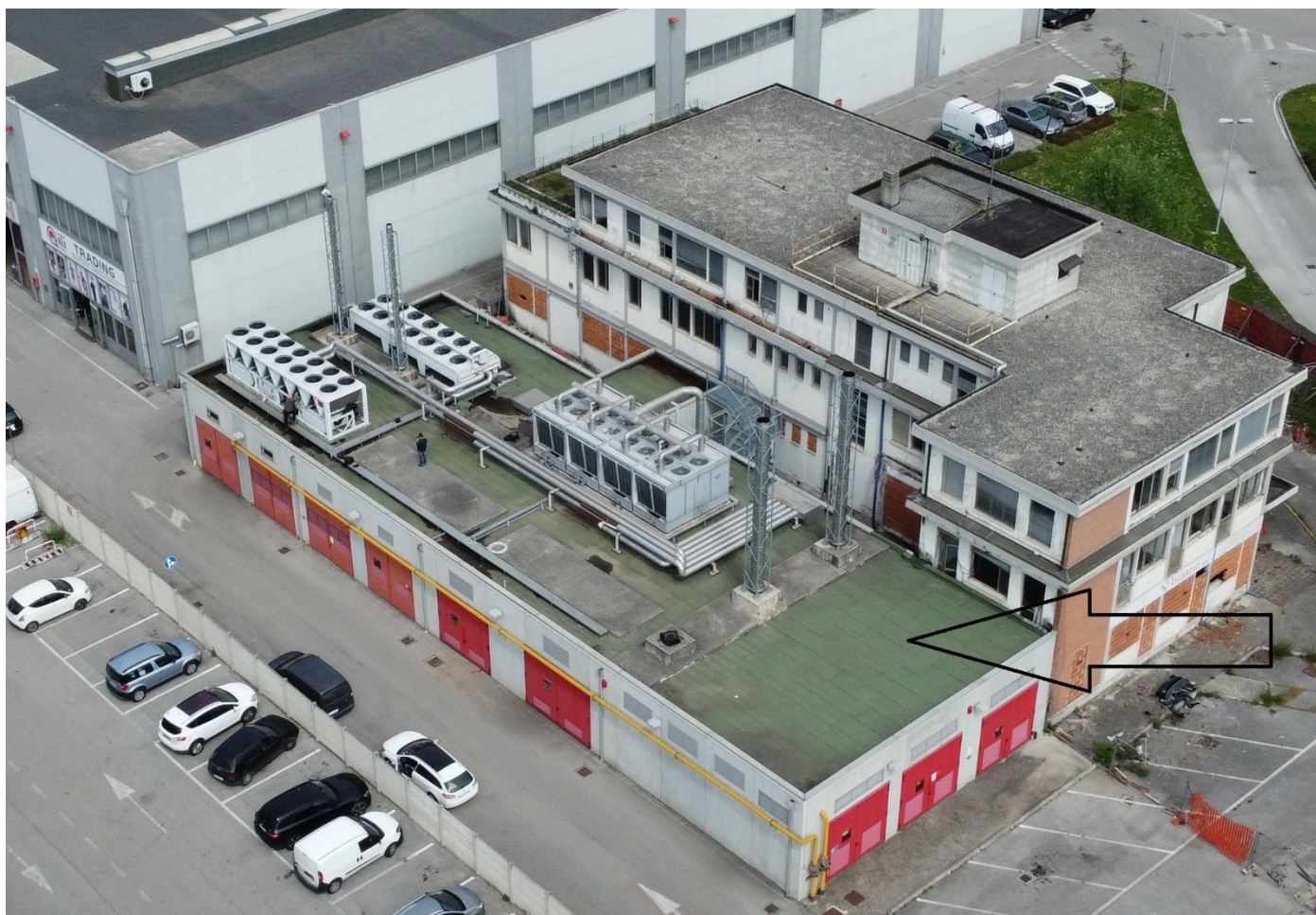
Figura 16, impianto di Telezip
