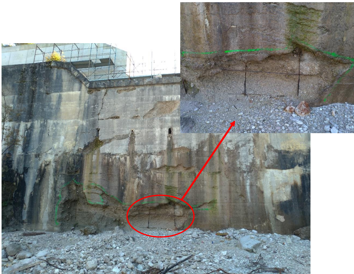
Figura 20. Briglia tradizionale degradata la piede, con delle importanti crepe per tutta la sua altezza (foto scattata dall'autore)
