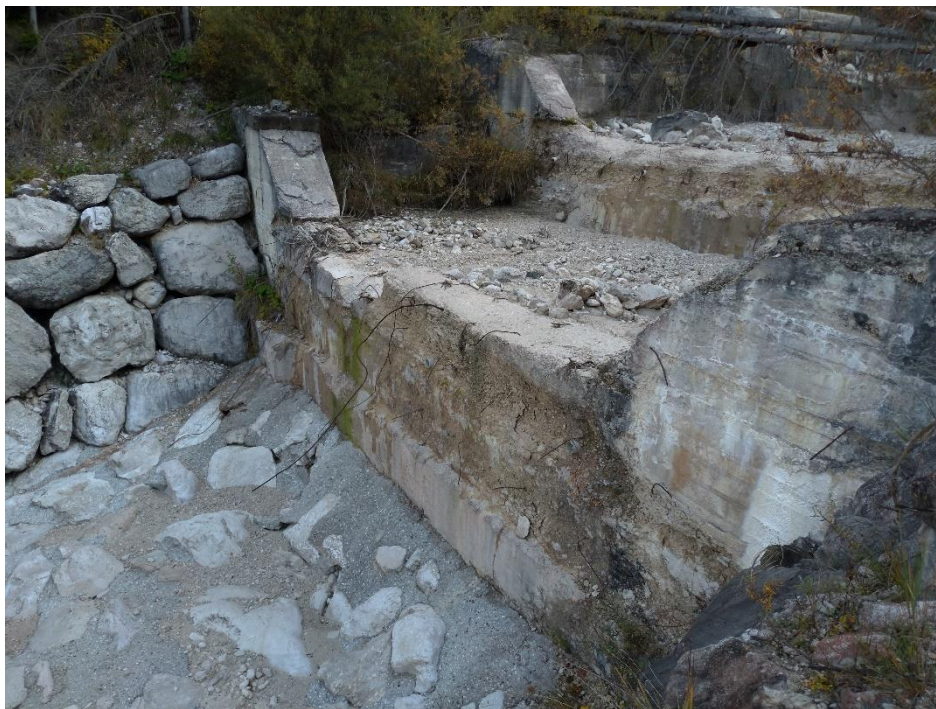
Figura 18. Briglia tradizionale dove il calcestruzzo è stato eroso dalla colata detritica e le armature risultano esposte e fortemente danneggiate (foto scattata dall'Autore)
