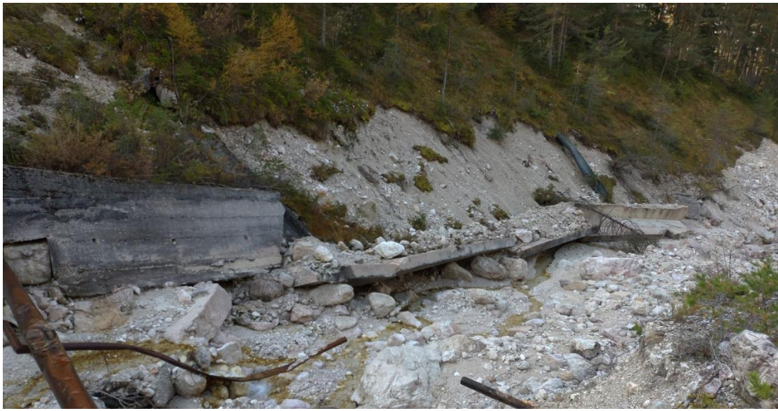
Figura 21. Muro spondale divelto dalla colata detritica, con erosione di tutto il materiale che tratteneva (foto scattata dall'Autore)
