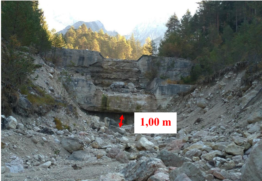
Figura 19. Briglia tradizionale fortemente degradata, dove le fondazioni risultano esposte (foto scattata dall'Autore)
