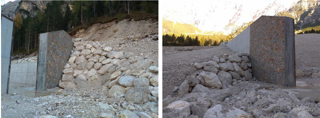
Figura 32. Ammorsamento della briglia in destra idraulica (destra) e sinistra idraulica (sinistra) (foto scattate dall'Autore)
