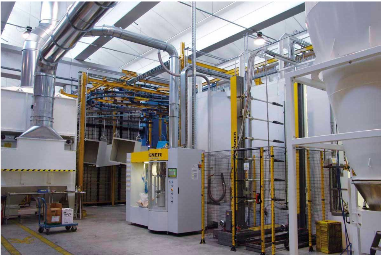
Figura 39, cabina verniciatura polvere, documentazione aziendale
