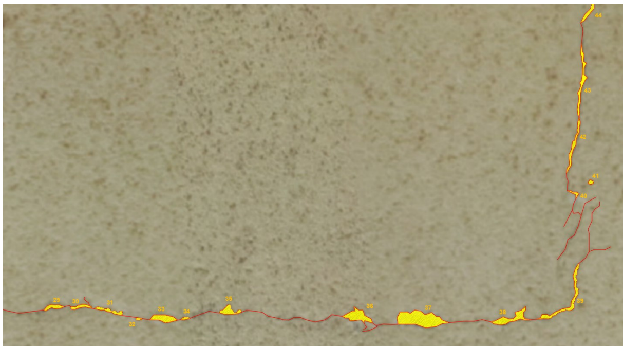
Figura 26: Dettaglio della restituzione della fessurazione nell'edificio a Cappellazzi, anno 2021;
