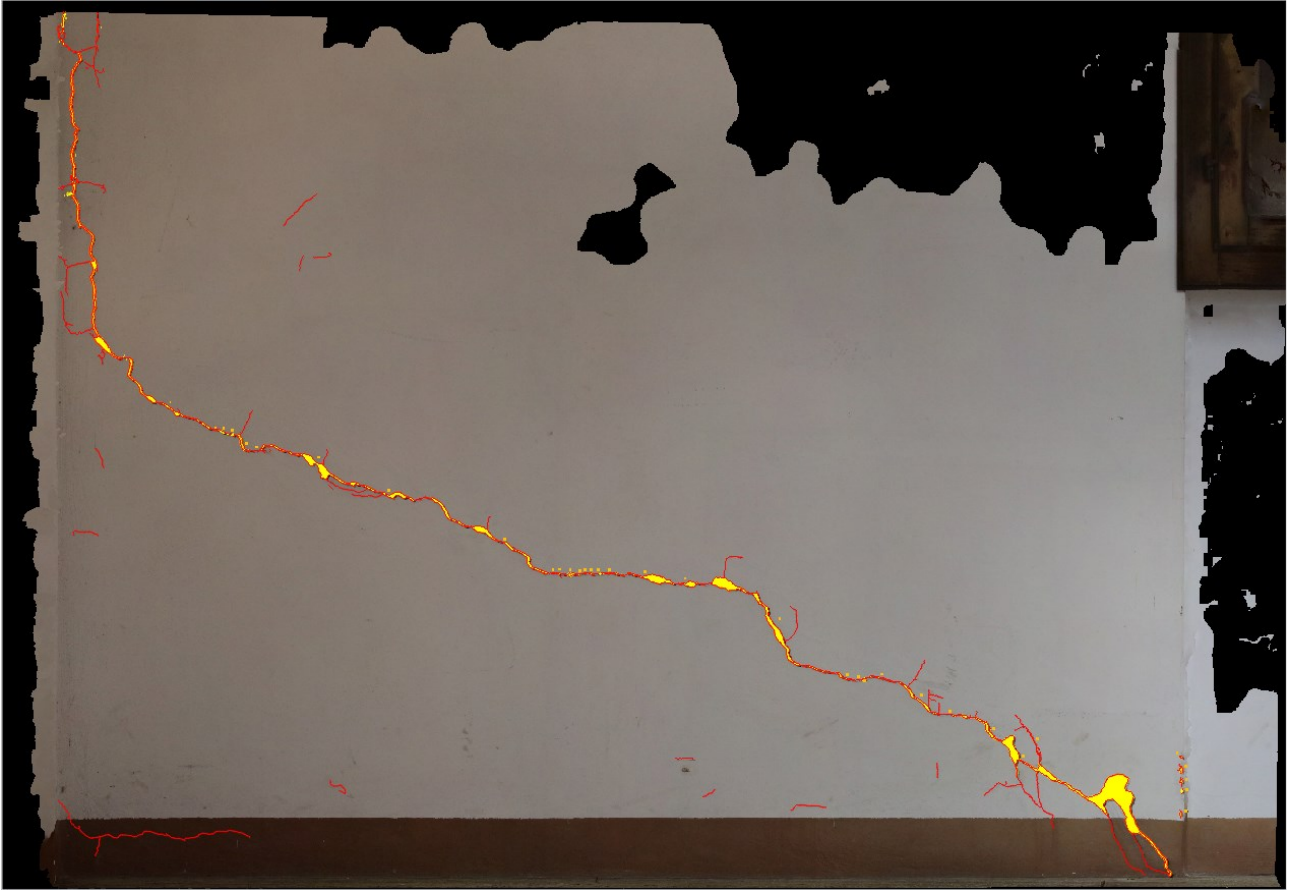
Figura 21: Restituzione della fessurazione nella chiesa a Rovigliana; in rosso è rappresentata la polilinea che descrive l'andamento della fessurazione e in giallo le zone in cui è stata calcolata l'area; anno 2021;
