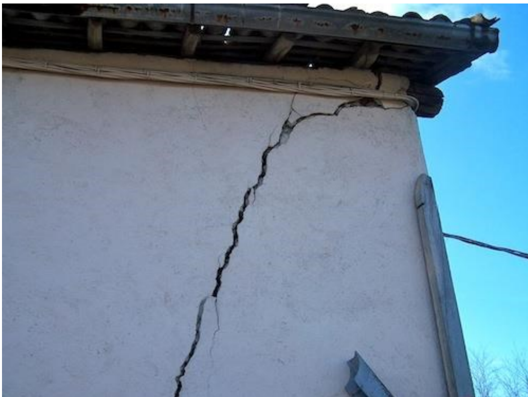
Figura 5: Fessurazioni causate da frane;
