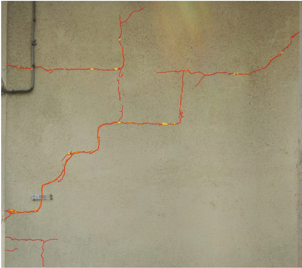
Figura 25: Restituzione della fessurazione nell'edificio a Cappellazzi; in rosso è rappresentata la polilinea e in giallo le zone in cui è stata calcolata l'area; anno 2021;
