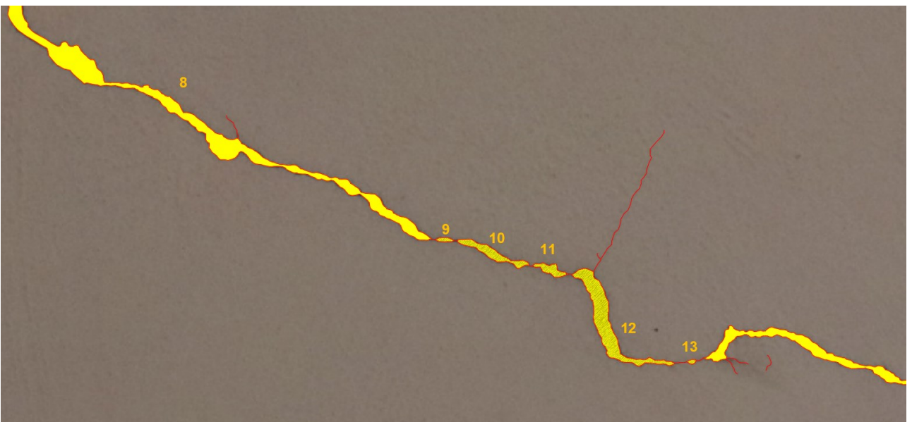
Figura 22: Dettaglio della restituzione della fessurazione nella chiesa a Rovigliana; anno 2021;
