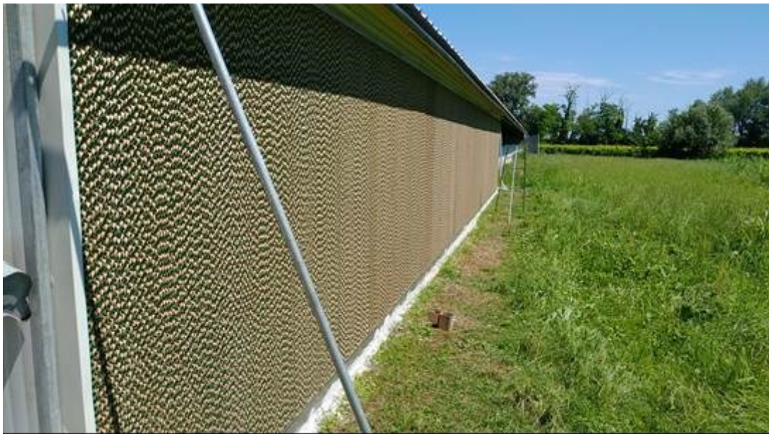
Figura 9. Pannello raffrescante a nido d'ape di un cooling system.
