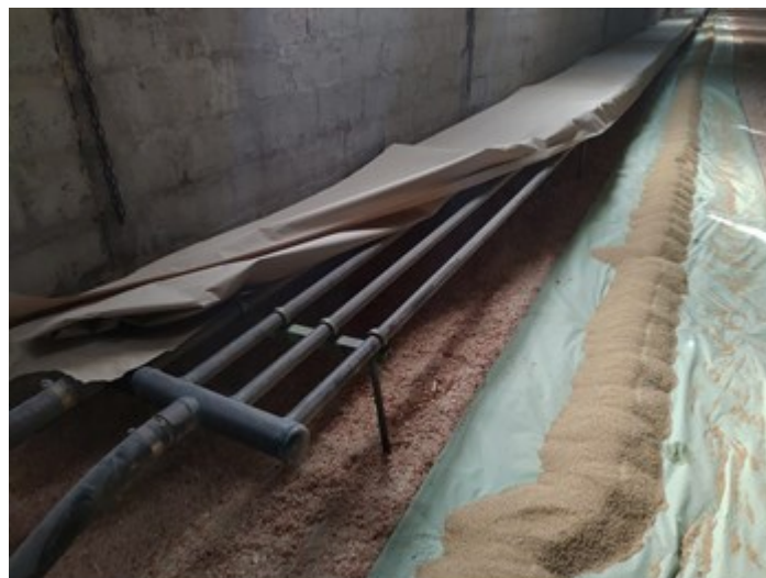
Figura 5. Pulcinaia con sistema di riscaldamento a tubiere, ricoperta dalla carta di isolamento.
