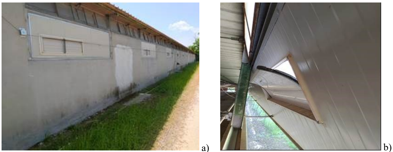
Figura 10. Disposizione delle finestre invernali (a); particolare della curvatura delle finestrelle invernali quando sono in posizione di apertura al 20% (b).
