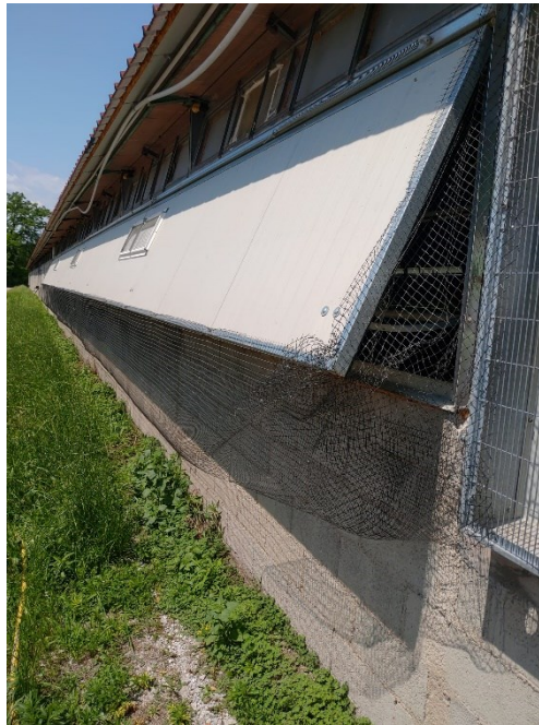
Figura 2. Esempio di finestrate di capannoni ad aria forzata. Le finestre più piccole sono le finestrelle invernali, l'apertura più grande è quella estiva.
