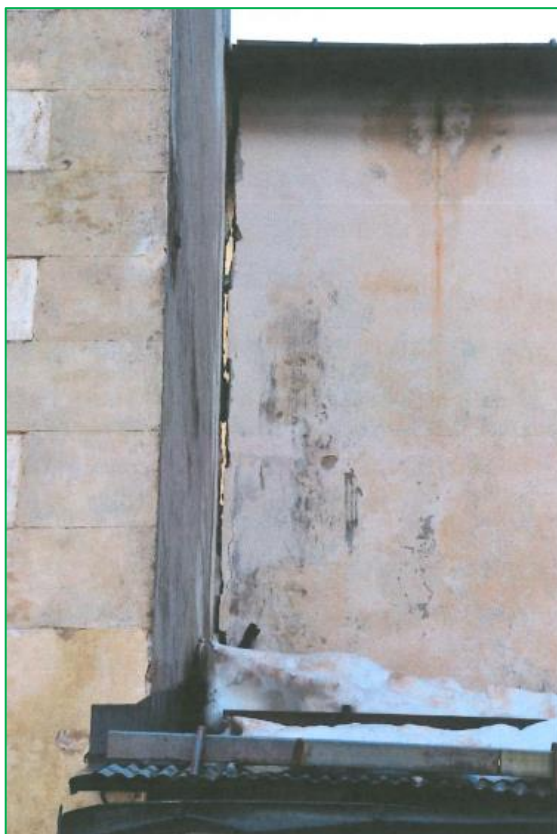
Figura 28 - Fessura fra abside e campanile [11]
