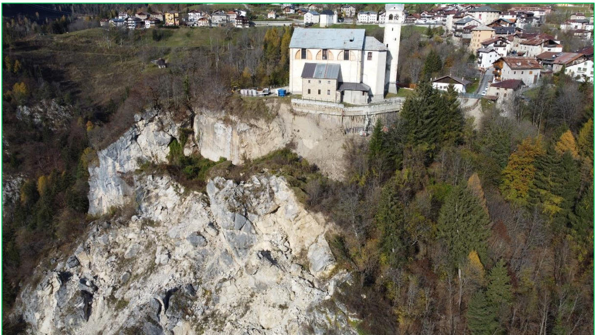
Figura 46 - foto aerea del cantiere e della frana
